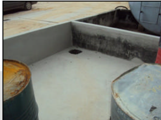
Foto 08. Armazenamento de resíduos oleosos em bacia de contenção.
