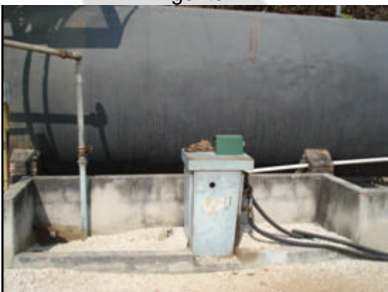
Foto 05. Bomba de abastecimento sem cobertura.
