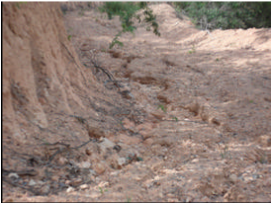
Foto 03. Erosões em estrada sem drenagem conforme normas técnicas vigente.
