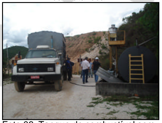
Foto 06. Tanque de combustível sem pista de abastecimento.
