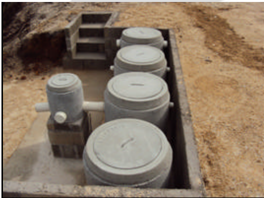
Foto 09. Caixa separadora de água e óleo que atende tanto o tanque quanto os resíduos oleosos.
