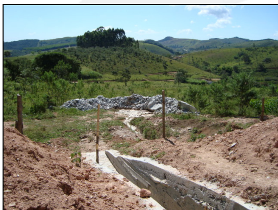
Foto 09. Sistema de drenagem de águas pluviais da cava.
