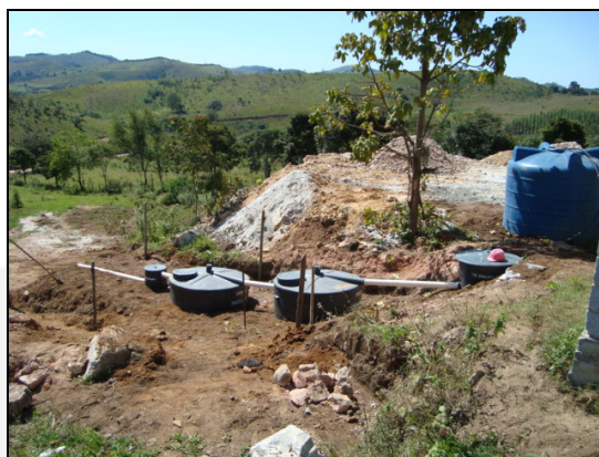
Foto 08. Sistema de tratamento de efluentes sanitários
