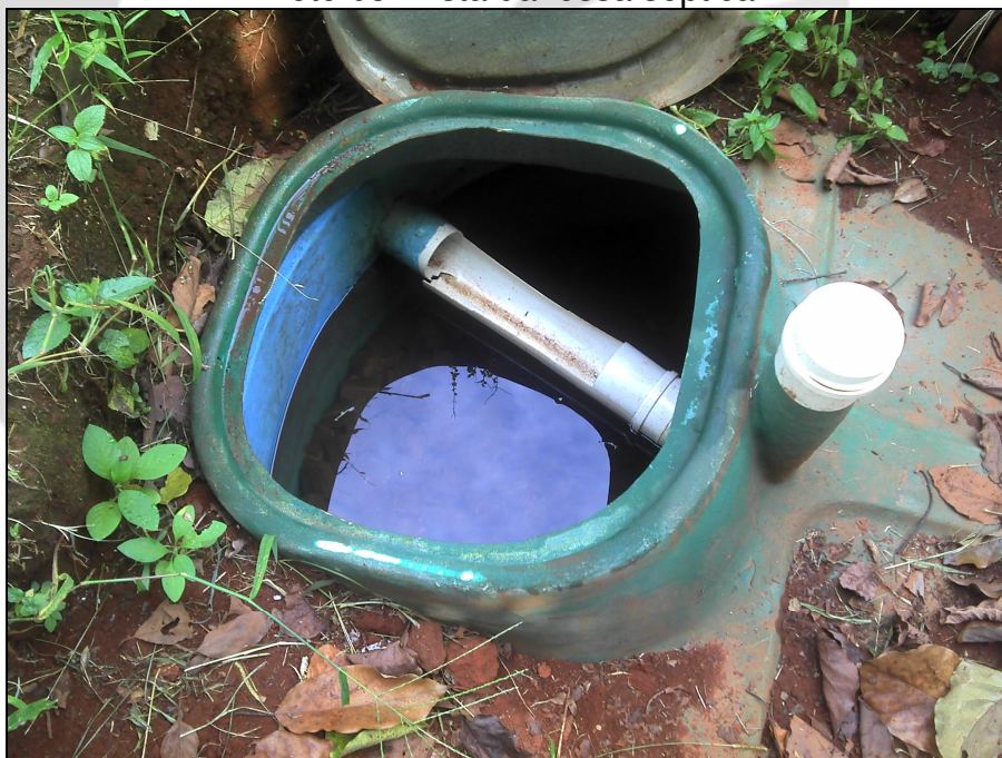
Foto 04: Vista do filtro anaeróbio (aberto)
