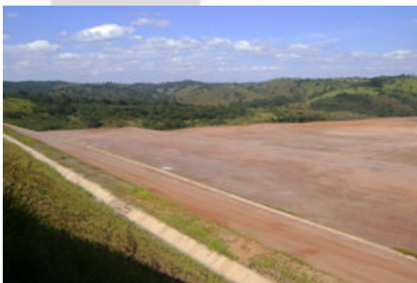
Foto 03: Vista do sistema de drenagem – Canaletas de condução de águas pluviais
