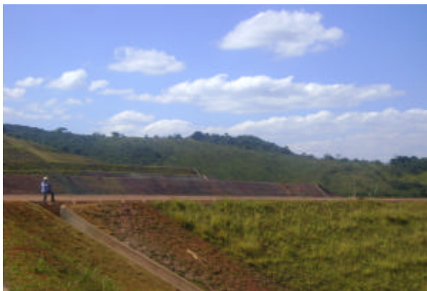
Foto 05: Vista dos sistemas de drenagem – Platôs
