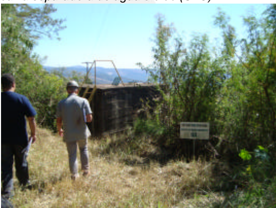
Foto 11. Sistema de contenção de efluentes sanitários.
