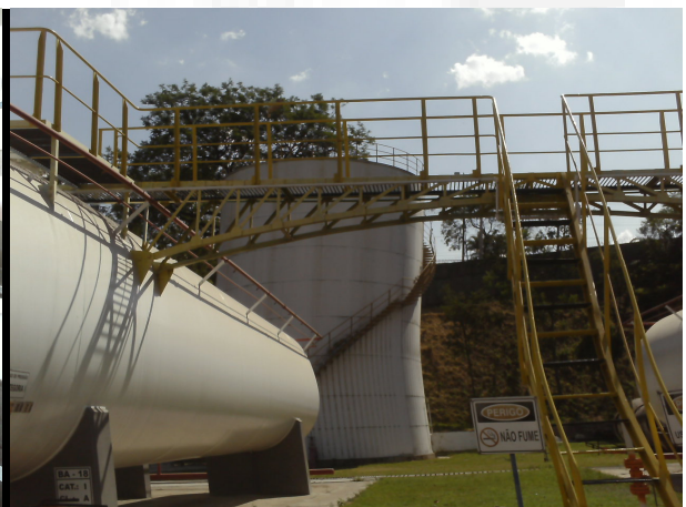
Foto 04. Tanques de armazenamento.
