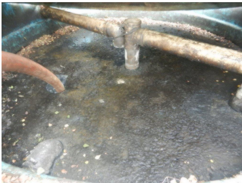
Foto: Lacramento, desativação da saída da ETE Sanitária e Recolhimento do Efluente por empresa licenciada – Brembo do Brasil Ltda
