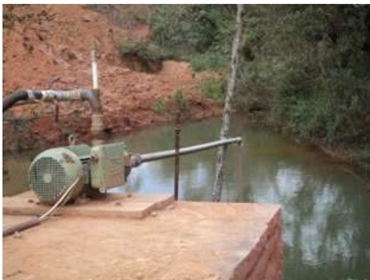
VISTA TANQUE / BOMBA D'ÁGUA
