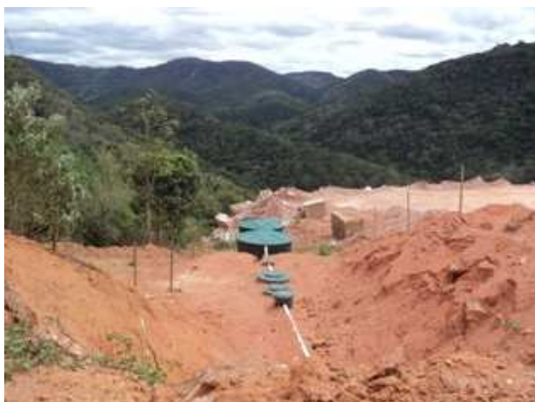
ESTAÇÃO DE TRATAMENTO DE ESGOTO
