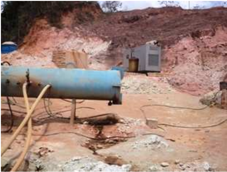
ÁREA DE EQUIPAMENTOS DE AR COMPRIMIDO
