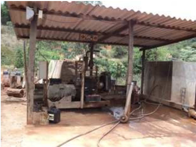
VISTA BOMBA D'ÁGUA / LAVAJATO
