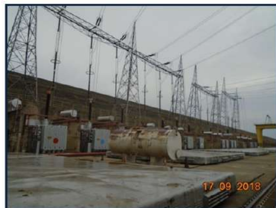
Foto 7 - Transformadores localizados na casa de força da UHE Três Marias
