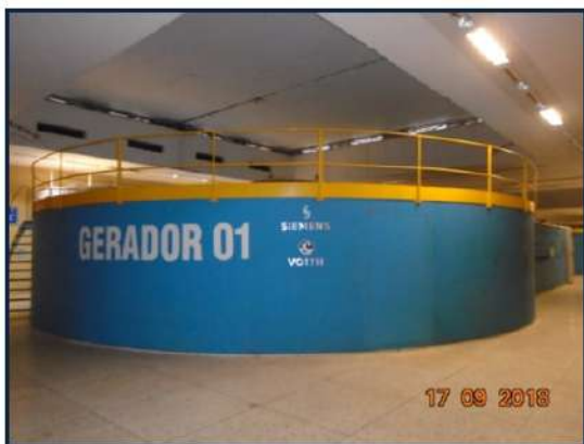
Foto 6 - Vista de um dos geradores da UHE Três Marias
