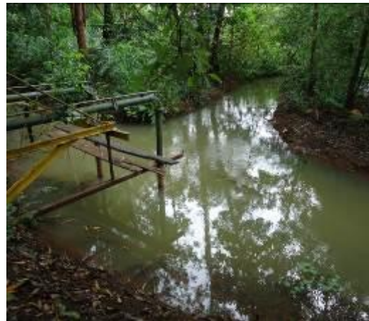
Foto 10. Captação superficial de água.
