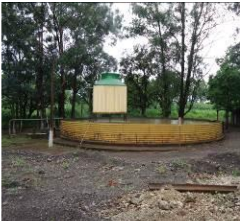
Foto 09. Tanque para a água industrial captada no córrego.
