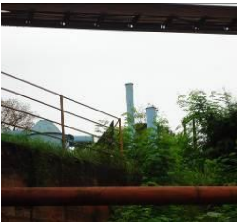
Foto 17. Chaminés dos filtros de mangas.
