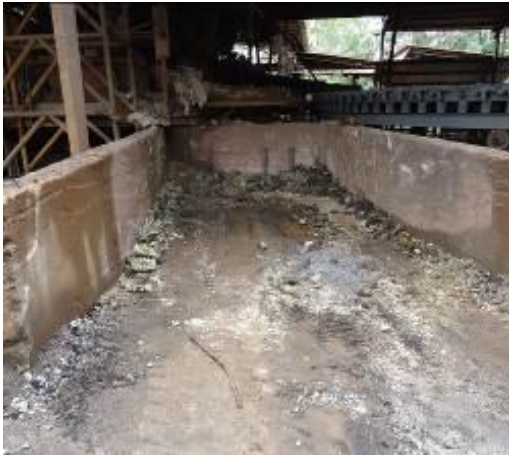
Foto 07. Baia para granulação de escória.
