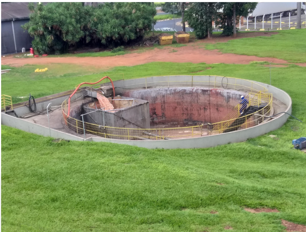
Foto vistoria, uma das melhorias efetuadas na saída dos efluentes industriais realizada ainda na fase de licença anterior para redução de odores (construção de caixa de inox).
