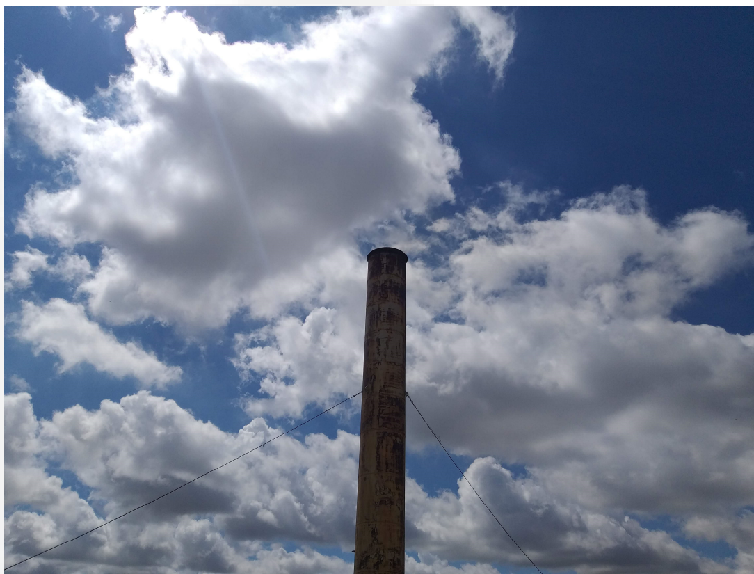
Foto da vistoria, exaustão (chaminé) da caldeira em funcionamento
