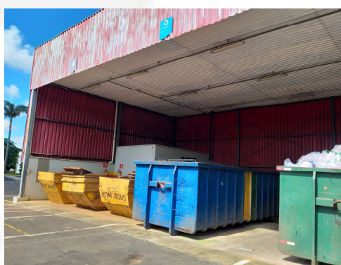
Armazenamento de resíduos sólidos
