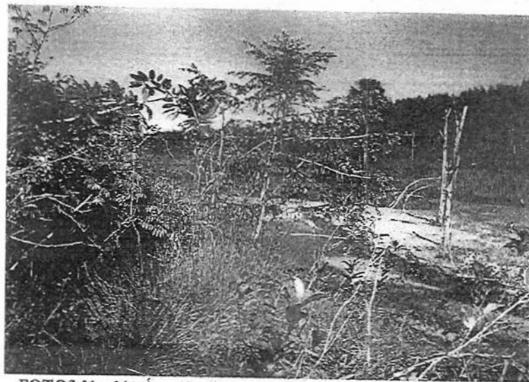
FOTOS 01 a 04 - Área do dique rompido, no ponto de coordenada média 668.408 / 8.078.167.
