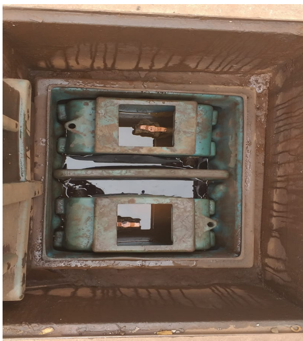
Foto 1 - Caixa SAO aberta
