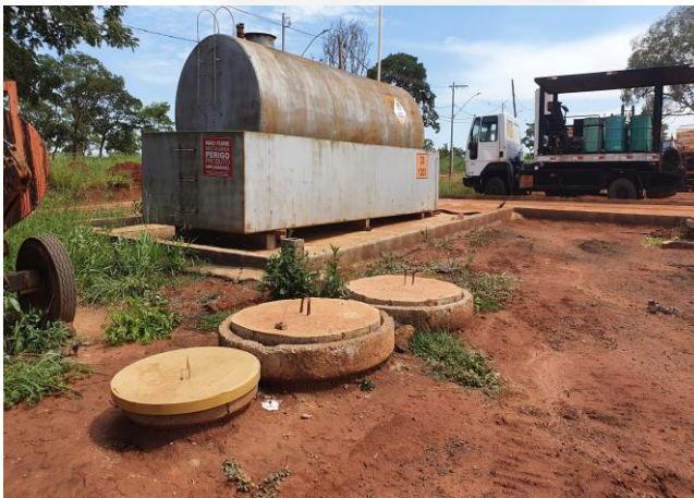
Figura 1: Caixa SAO – ponto de abastecimento.
