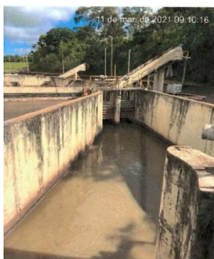
Figura 1: Chegada do esgoto bruto.
