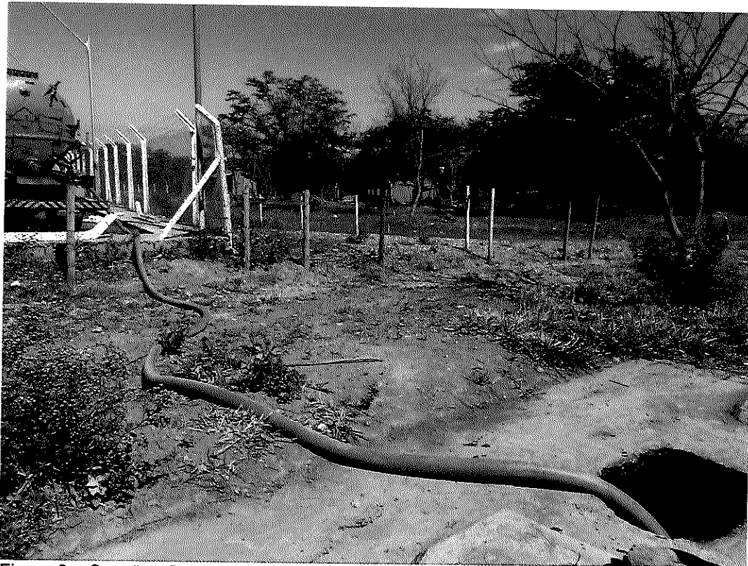
Figura 2 – Sucção efluente sanitário – Fonte: Moura 2015.
