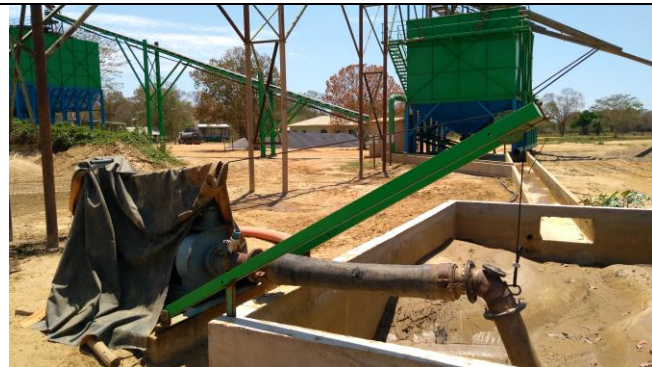
Foto 1. Sistema de peneiramento, esteira e silos
