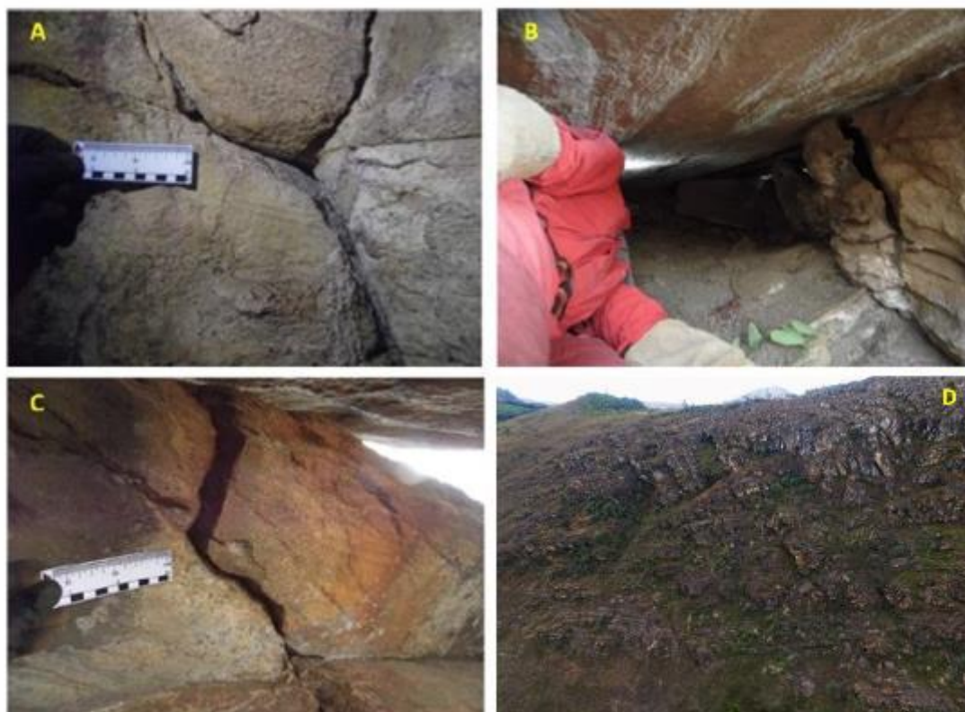
Figura 5.1: Trincas no teto da cavidade PDR-0010. (B) Trinca centimétrica em bloco e (C) trinca na parede da cavidade PDR-0011. (D) Contexto ruíniforme de inserção das cavidades PDR-0010 e PDR-0011.
