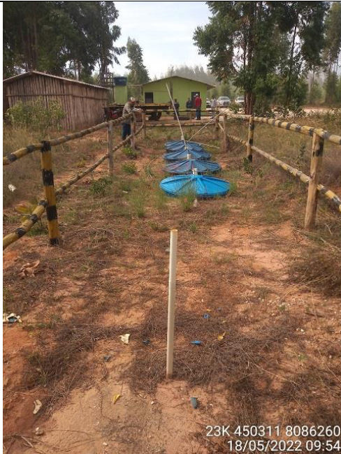
Sistema de tratamento de efluentes sanitários.
