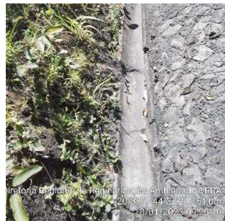
Foto 04. Sistema de drenagem pluvial.
