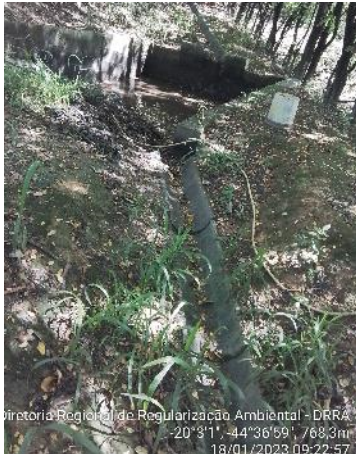
Foto 05. Sistema de drenagem pluvial.
