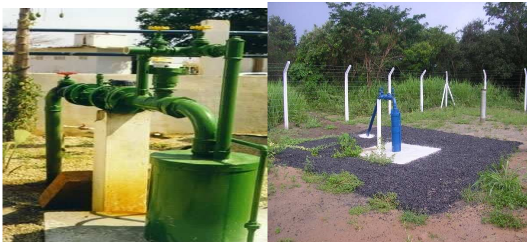
Figura 12 – Captações por meio de poços tubulares
