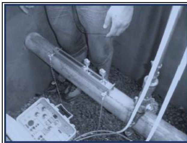
Figura 4.15: Medidores de vazão (ultrassônico e medidor diferencial/Pitot)
