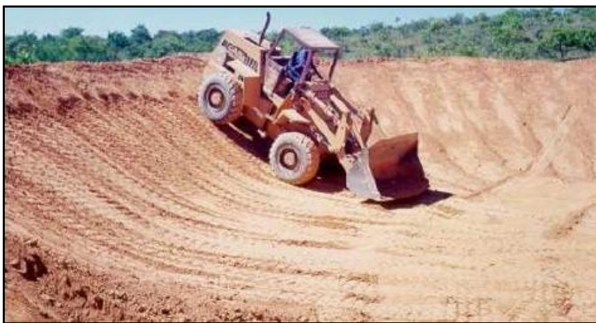
Figura 4.1: Construção de bacia de contenção de enxurrada em Sete Lagoas – MG. (EMBRAPA, 1997)
