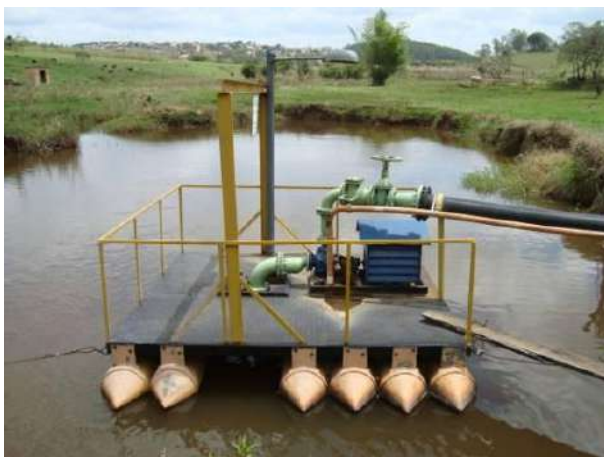
Figura 211 - Em destaque a balsa de captação para o abastecimento doméstico e industrial da sede municipal de Cana Verde.
