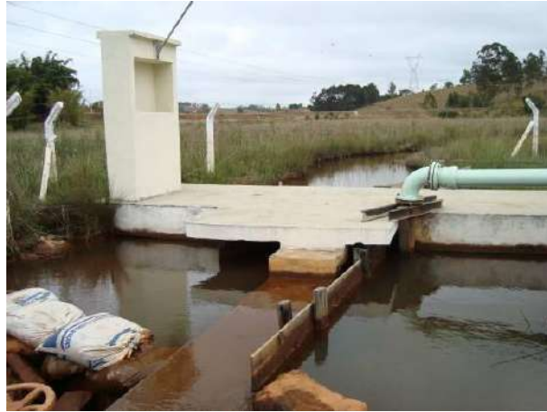
Figura 131 - Ponto de captação para o abastecimento doméstico e industrial da sede municipal de São Tiago.
