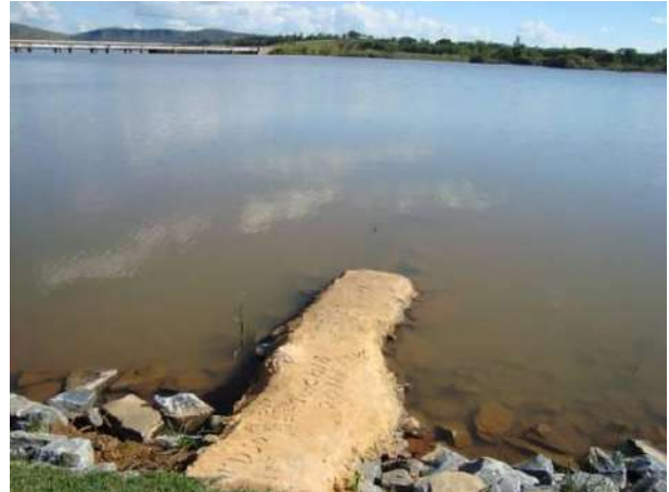
Figura 149 - Ponto de lançamento de esgoto tratado do distrito Macaia.
