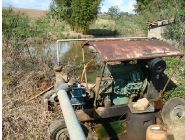
Figura 164 - Ponto de captação para irrigação por aspersão.
