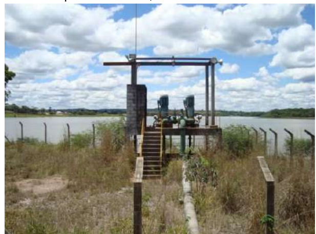
Figura 153 - Ponto de captação para o abastecimento industrial.
