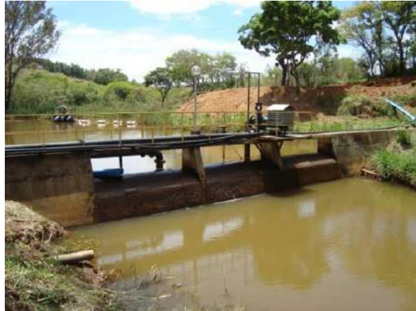
Figura 205 - Ponto de captação para o abastecimento doméstico e industrial da sede municipal de Santo Antônio do Amparo.
