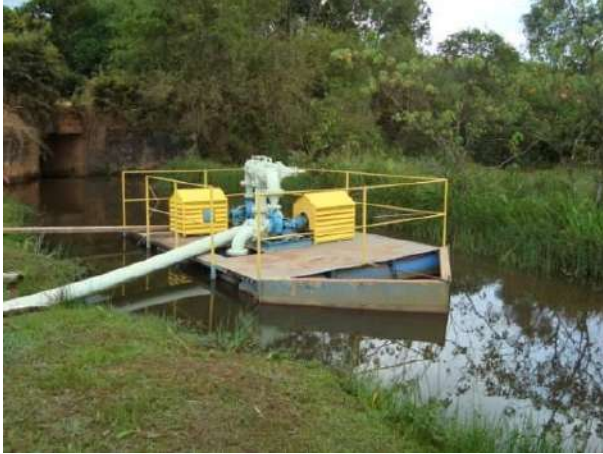
Figura 171 - Ponto de captação para o abastecimento doméstico e industrial da sede municipal de São Bento Abade.
