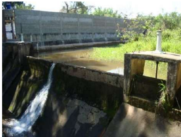
Figura 167 - Ponto de captação para o abastecimento doméstico e industrial da sede municipal de Lavras.
