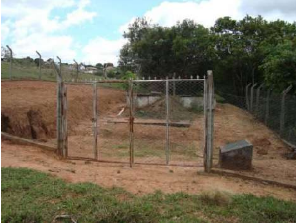
Figura 175 - Filtro para retirada dos resíduos sólidos provenientes dos efluentes domésticos do povoado rural Palmital do Cervo (Carmo da Cachoeira).
