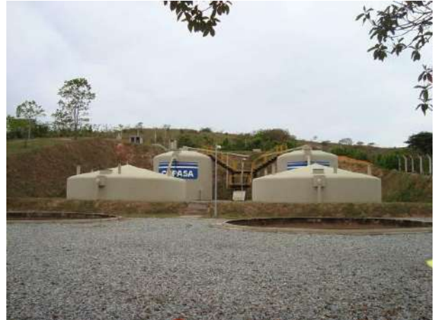
Figura 125 - Estação de tratamento de efluentes da sede municipal de Conceição da Barra de Minas.
