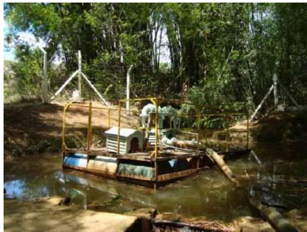
Figura 174 - Ponto de captação para o abastecimento doméstico do povoado rural Palmital do Cervo (Carmo da Cachoeira).
