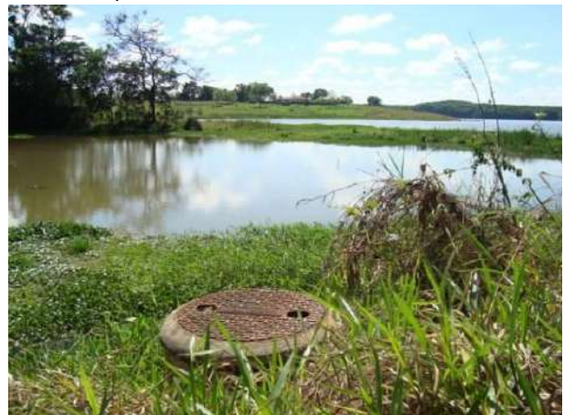
Figura 151 - Ponto de lançamento de esgoto tratado da sede municipal de Ijaci.
