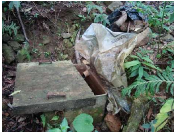
Figura 160 - Ponto de captação para o abastecimento doméstico da sede municipal de Ijaci (somente o bairro Vila Industrial).
