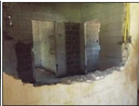
Cômodo inacabado anexo à Edif. 1
