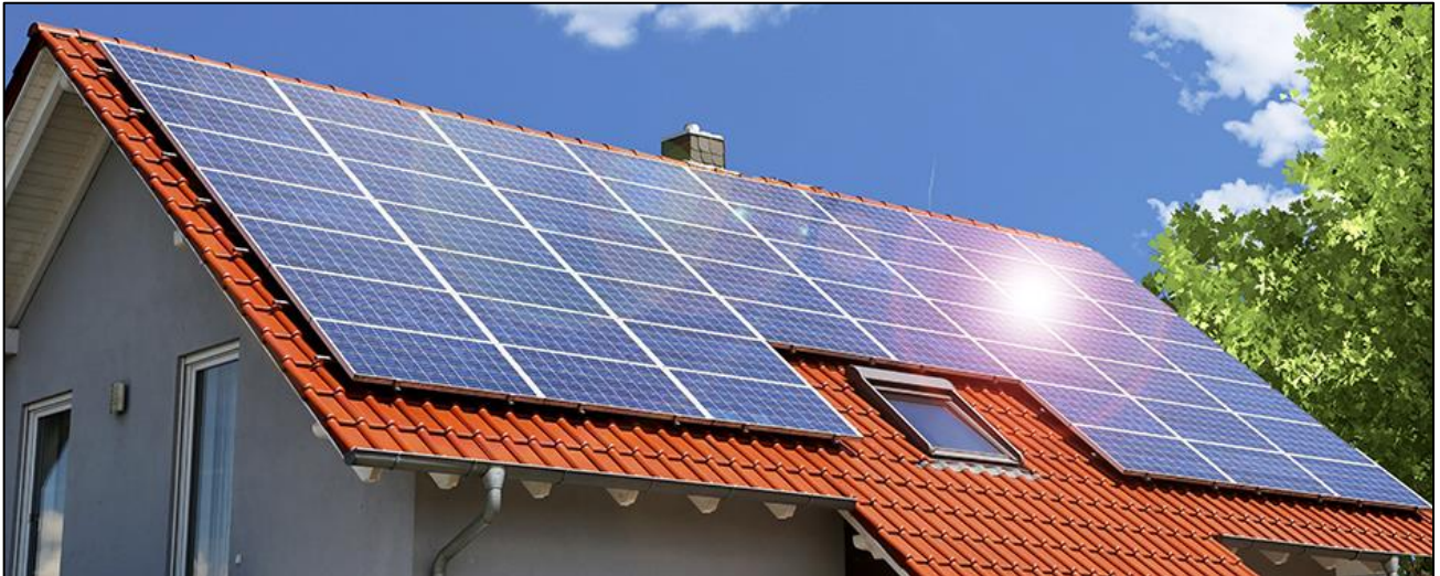
Foto: Crédito – Painéis de Energia solar fotovoltaica em telhado de uma residência – Portal Solar – 2020.
